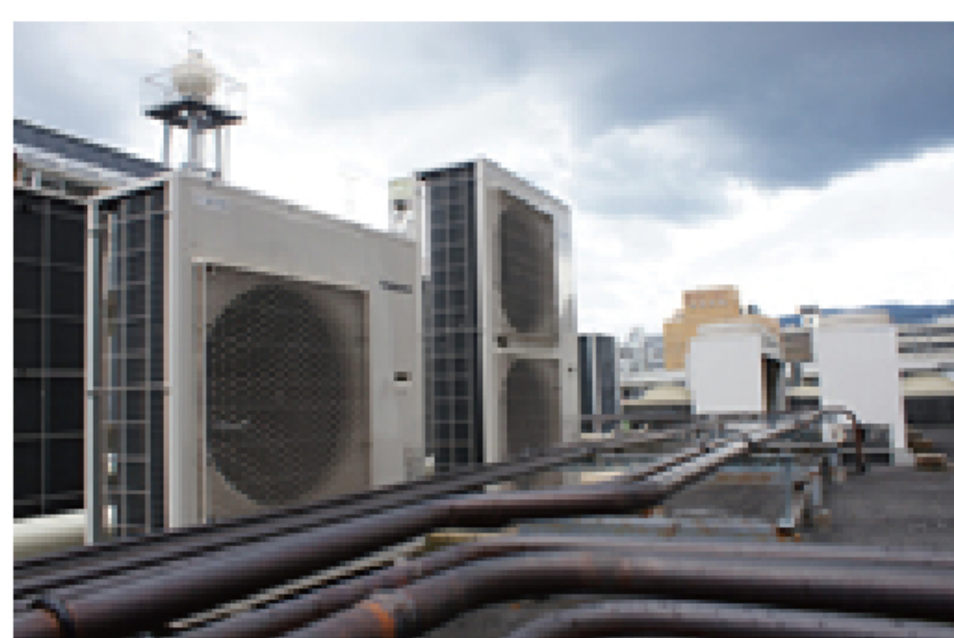
空調機の室外機
