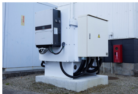
パワーコンディショナー (関西電力資産)
